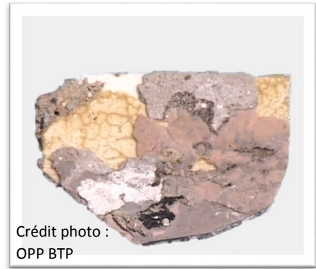
Colle amiantée en sous face de dalle plastique
